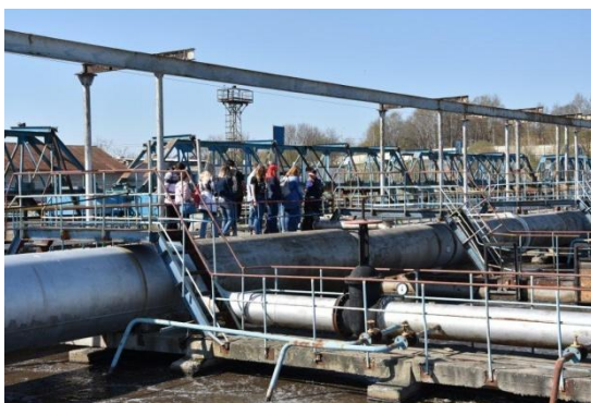
Рисунок 2 – ГП «Калугаоблводоканал», «Калужские очистные сооружения»
